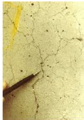
3. Ábra: Példa a száradási zsugorodási repedésre
