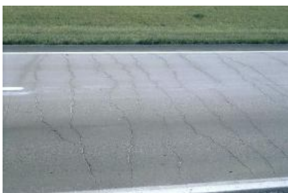
4. Ábra: Példa a nagy hőmérséklet ingadozás okozta repedésre
