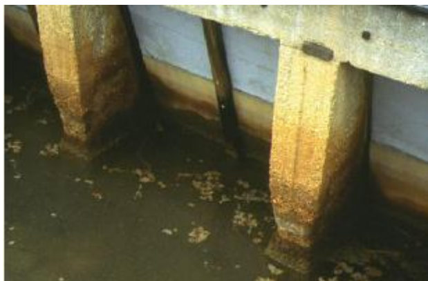
10. Ábra: Példa a vegyszerek hatása által okozott betonkárosodásra
